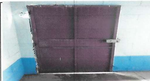
Foto 3: pintura en la puerta presenta deterioro y oxido
