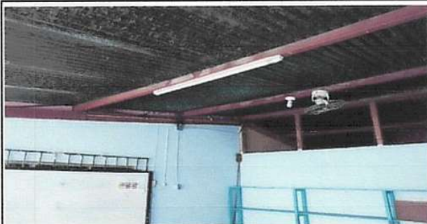
Foto 2: pintura en mal estado, en costaneras presenta humedad
